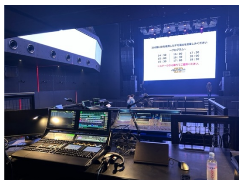
手前が照明卓、奥が音響卓
